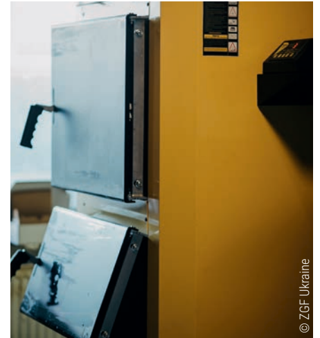
Der neue Heizkessel im Hutsulshchyna-Nationalpark, der angeschafft wurde, nachdem der alte zu Beginn des Winters ausgefallen war.
